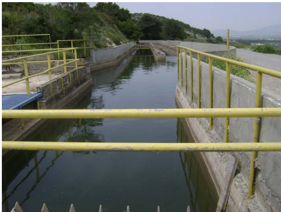
Εικόνα 2.5 Σταθμός ΕΥΔΑΠ στην περιοχή του Αγ. Θωμά, Μάιος 2009
