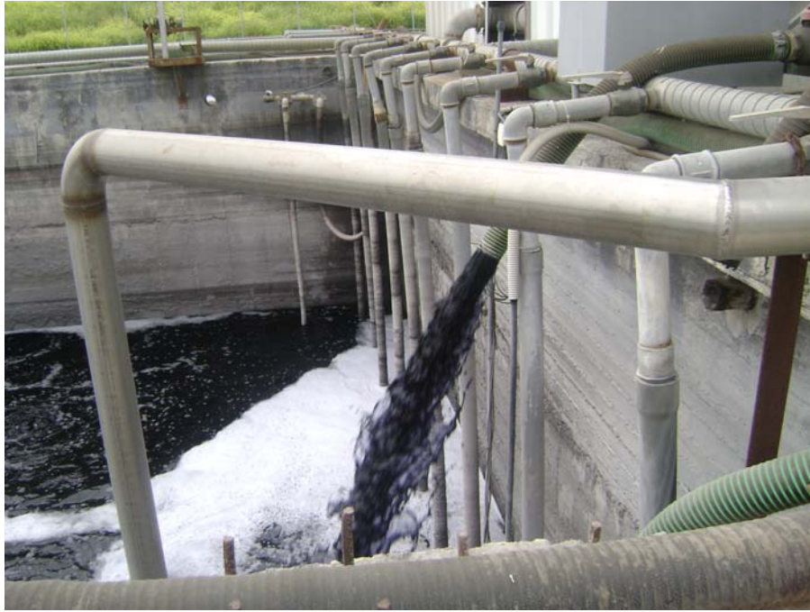
Σχήμα 4.8 Είσοδος της δεξαμενής ομογενοποίησης από τα διάφορα τμήματα παραγωγής υγρών αποβλήτων
