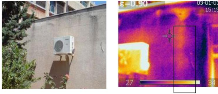
Εικόνα 5.2 : Παράδειγμα απουσίας μόνωσης και ανάπτυξης μούχλας σε εξωτερική τοιχοποιία
