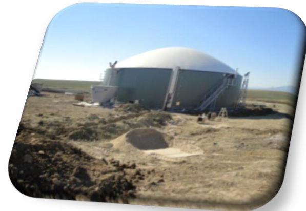
Bioaerio Komotinis S.A 0.50MW
